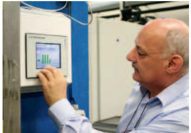
Mit einem e-Web Panel für die Gebäudeautomation überwacht Erwin Brügger verschiedene Prozessdaten in der Produktionshalle, darunter den Energieverbrauch jeder einzelnen Maschine.
